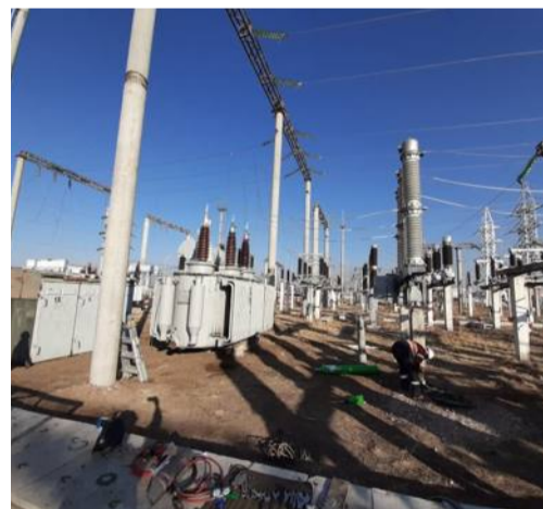
Мөрөн дэд станц Т-3
